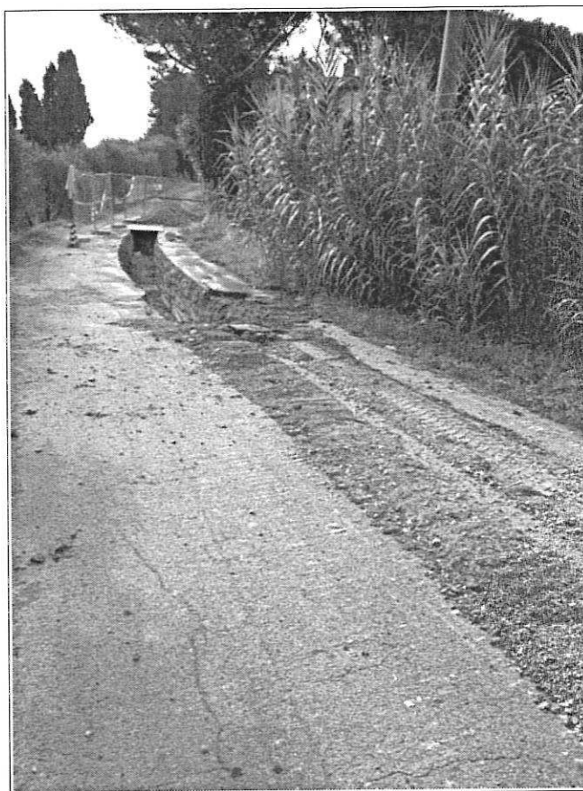
Figura 12 - Immagine del materiale di riempimento dello scavo (misto cementato con KEU) in Via Gioielli (foto fornita da Ingegnerie Toscane S.r.l.).
