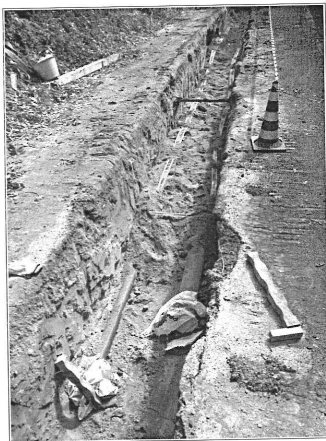
Figura 10 - Immagine delle tubazioni posate al fondo dello scavo in Via Gioielli (foto fornita da Ingegnerie Toscane S.r.l.).
