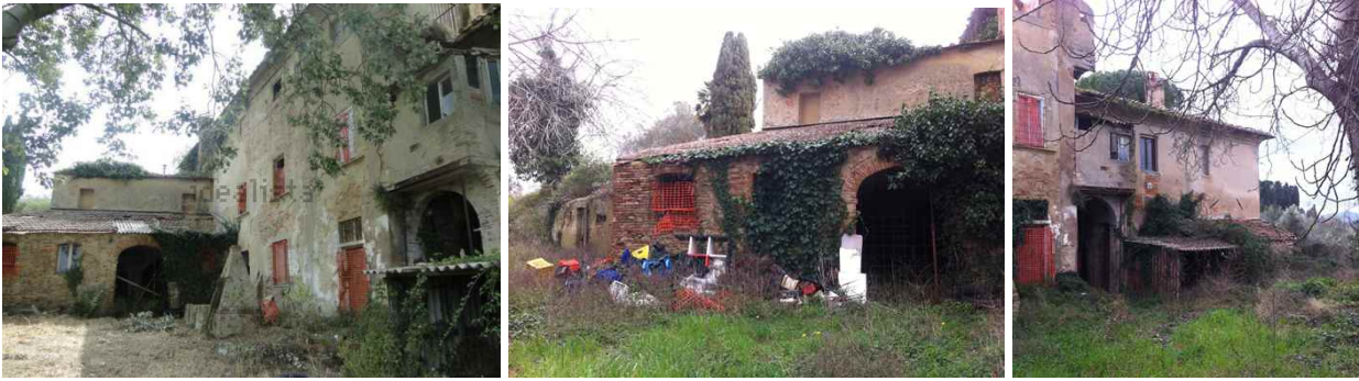
Viste del retro: si può notare lo stato di degrado e la presenza invadente delle superfetazioni
